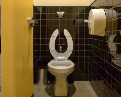
Baños cerca a las estaciones de trabajo
